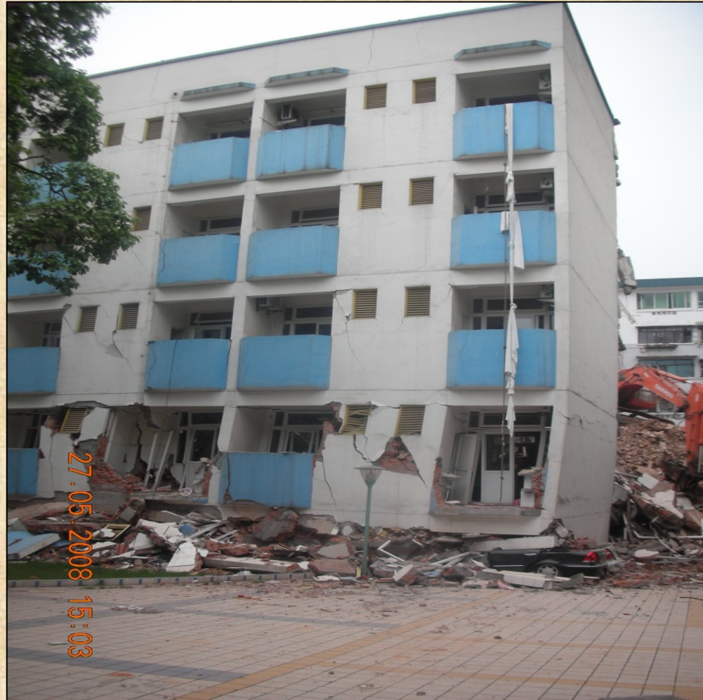
震後嚴重受損的舊址住院樓
