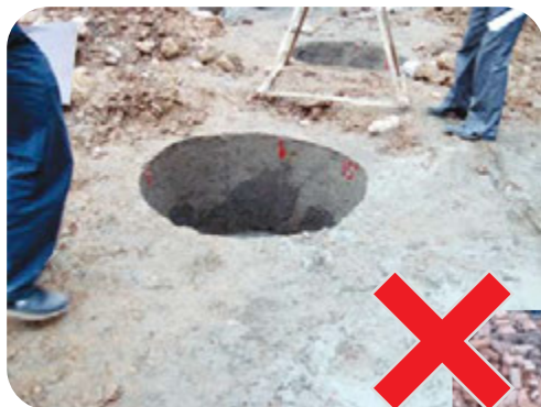
图4-1：挖孔面没有防护栏，工友及物料容易堕下
