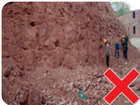
图3-8：边坡工程没有支撑和防护，工友处于危险的置下工作
