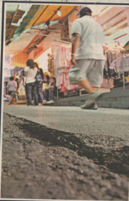
路陷現場附近牌檔地面仍有下陷迹象。
