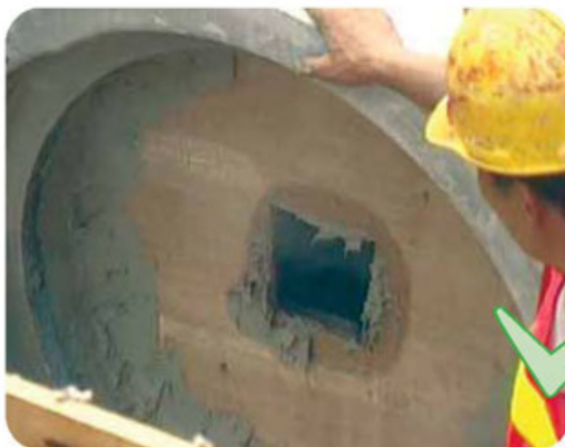
▲ 于排水管进行“试烟” 或“试水”测试
