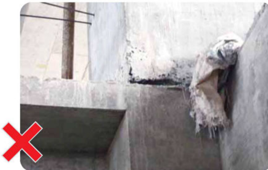
▲ 模板底部没有安装固定脚板，导致混凝土漏浆
